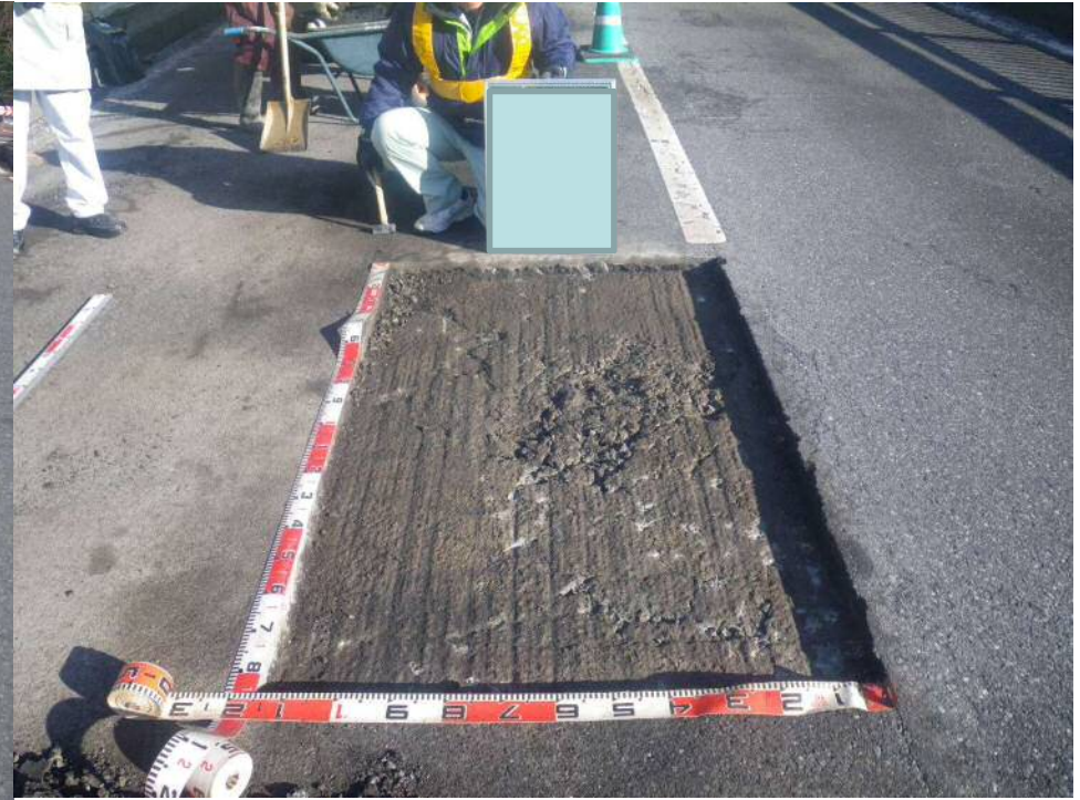
床版の土砂化
