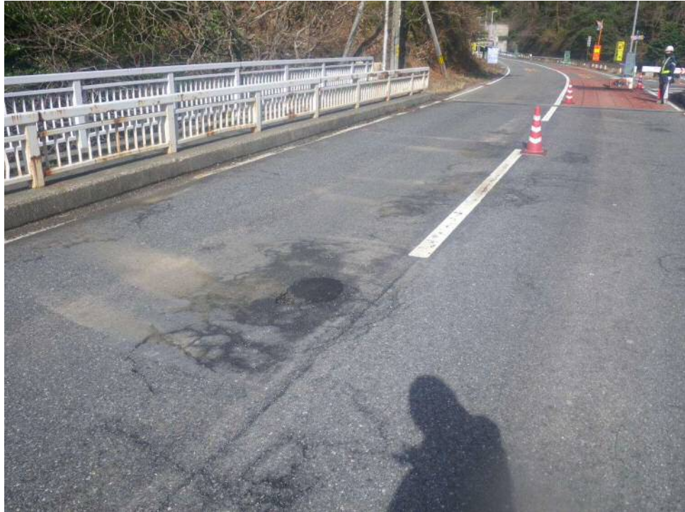
舗装表面ポットホール
